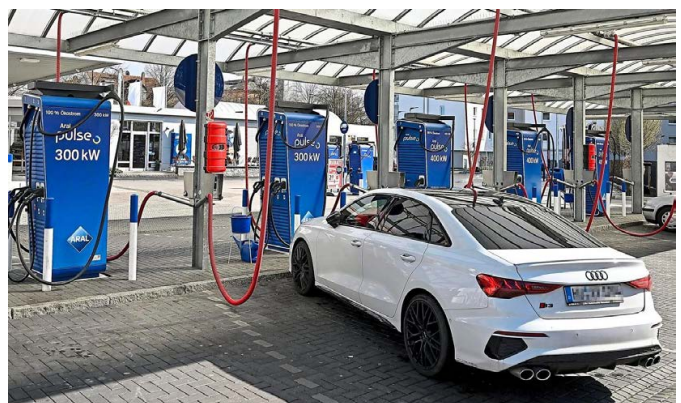
Unterläge die Energiewende nicht ständigen Auf und Abs, könnten die zehn E-Ladepunkte hier an der Brüder-Grimm-Straße ausgelastet sein. Eine E-Ladesäule kostet das Drei- bis Vierfache einer herkömmlichen Kraftstoffzapfsäule. Doch das Hauptgeschäft wird mit Benzin und Diesel gemacht.
